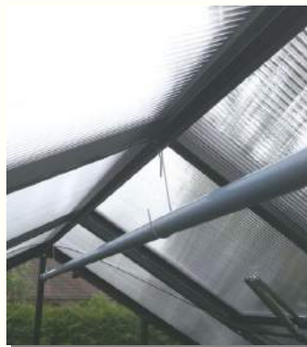
Rampe de brumisation
